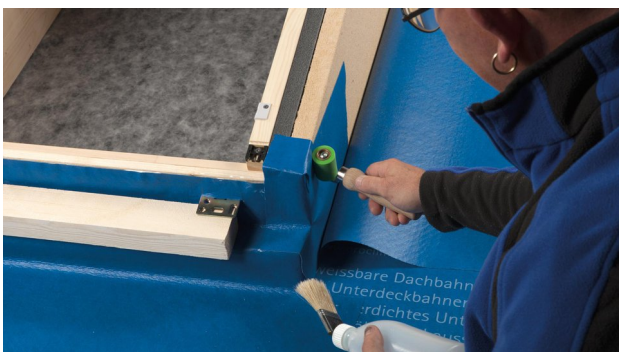
15. Überstände umfalten und mit der unteren Bahn verschweißen. Dabei besonders auf die Dichtheit der Ecken achten.
